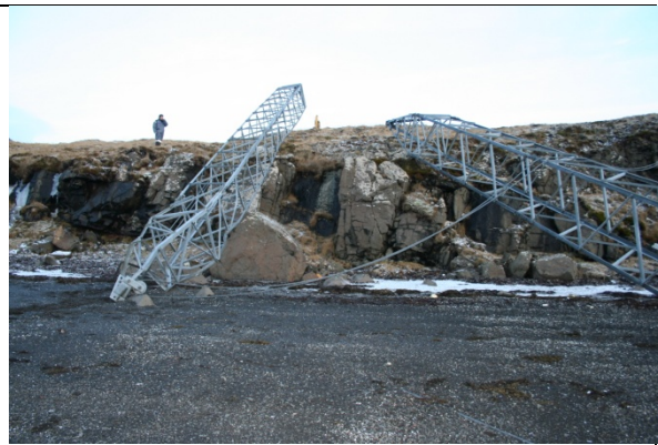
Mynd 9 Bilun á 220 kV Brennimelslínu, turnbrot - 30 klst. viðgerðatími
