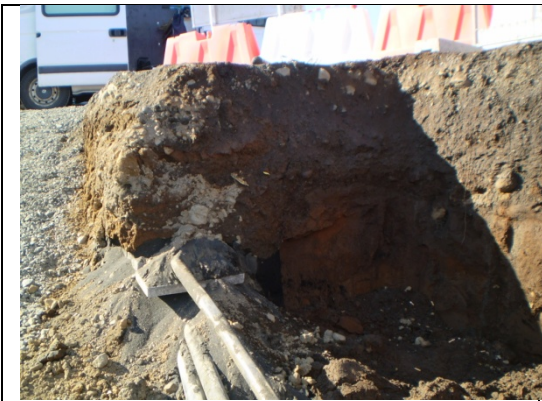
Mynd 8 Bilun á 132 kV Nesjavallastreng - 9 daga viðgerðatími
